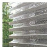
屋外冷却装置 (ドリブルルーバー)
